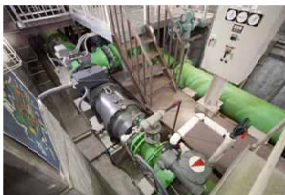
小水力発電 （定格出力 75kw/h、 平成 21 年度実績：467,722kwh/年）
